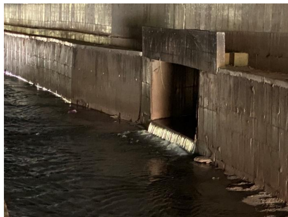
Imagem de água sendo despejada no Córrego Sarandi, oriunda de galerias pluviais, em frente ao Shopping Contagem – Av. Severino Balesteros
